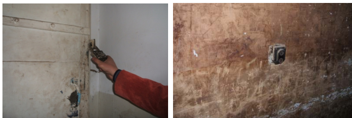
图 2 辐照室安全设施情况（辐照室门采用挂锁，无与放射源提升系统联锁措施；迷道内无防人误入光电联锁，辐照室内唯一的紧急降源按钮早已损坏）
